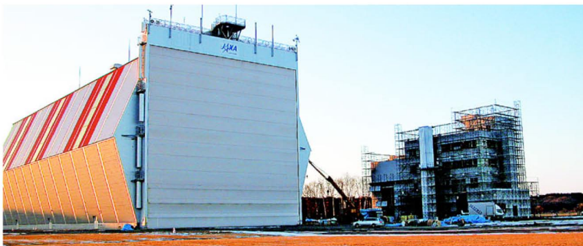
大気球指令管制棟の建設工事が進む町多目的航空公園。名実ともに、航空宇宙産業基地としての基盤が整いつつある
